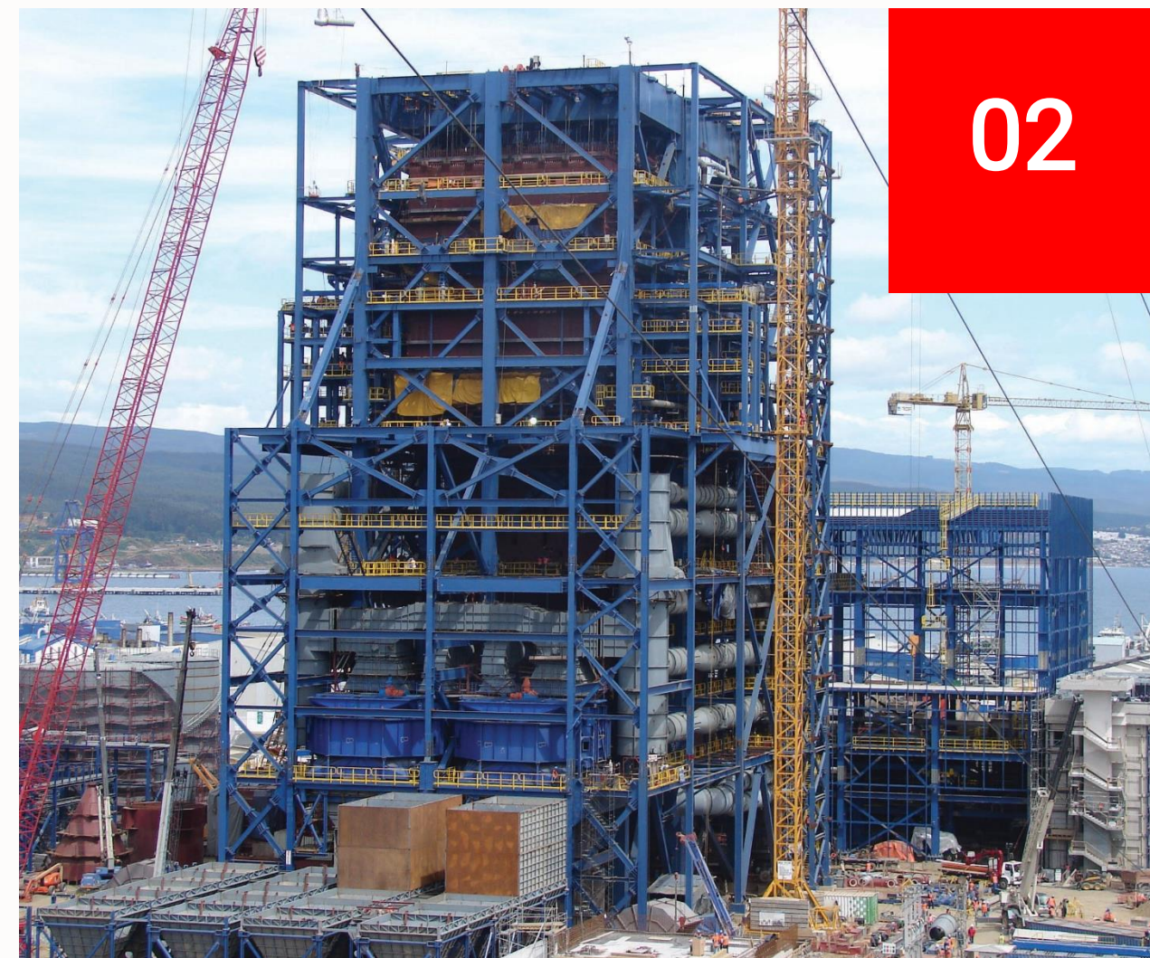
CENTRAL BOCAMINA II .....
